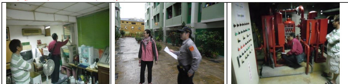
四十三、5月21日(覆檢-合格)：楠梓區德民路113號10樓租屋群警、消租屋安全評核情形
