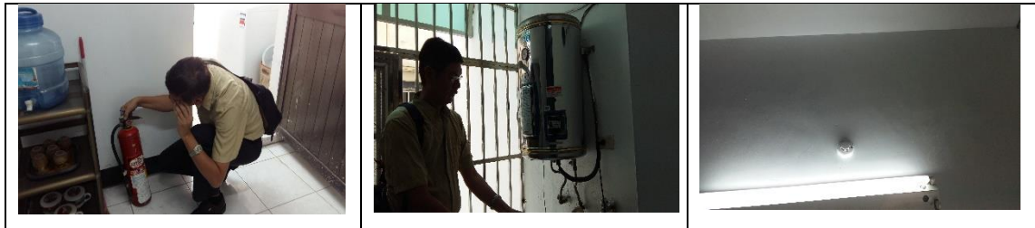
四十六、5月15日(覆檢合格)：高雄市楠梓區清平街20之1號6樓租屋群安全評核情形
