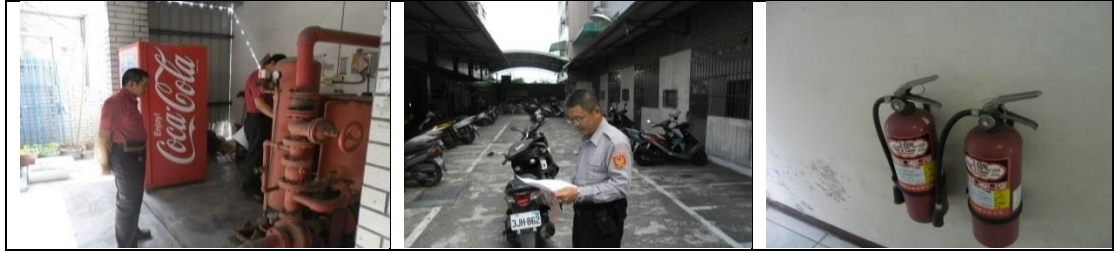
四、11月7日(覆檢合格)：燕巢區東川路15-1號(王先生-0920047100)租屋群警、消租屋安全評核情形
