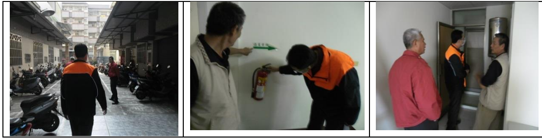
六、11月7日(覆檢-合格) 燕巢區鳳雄里鳳西二街24號(陳00-電話：0933-317561)租屋群警、消租屋安全評核情形
